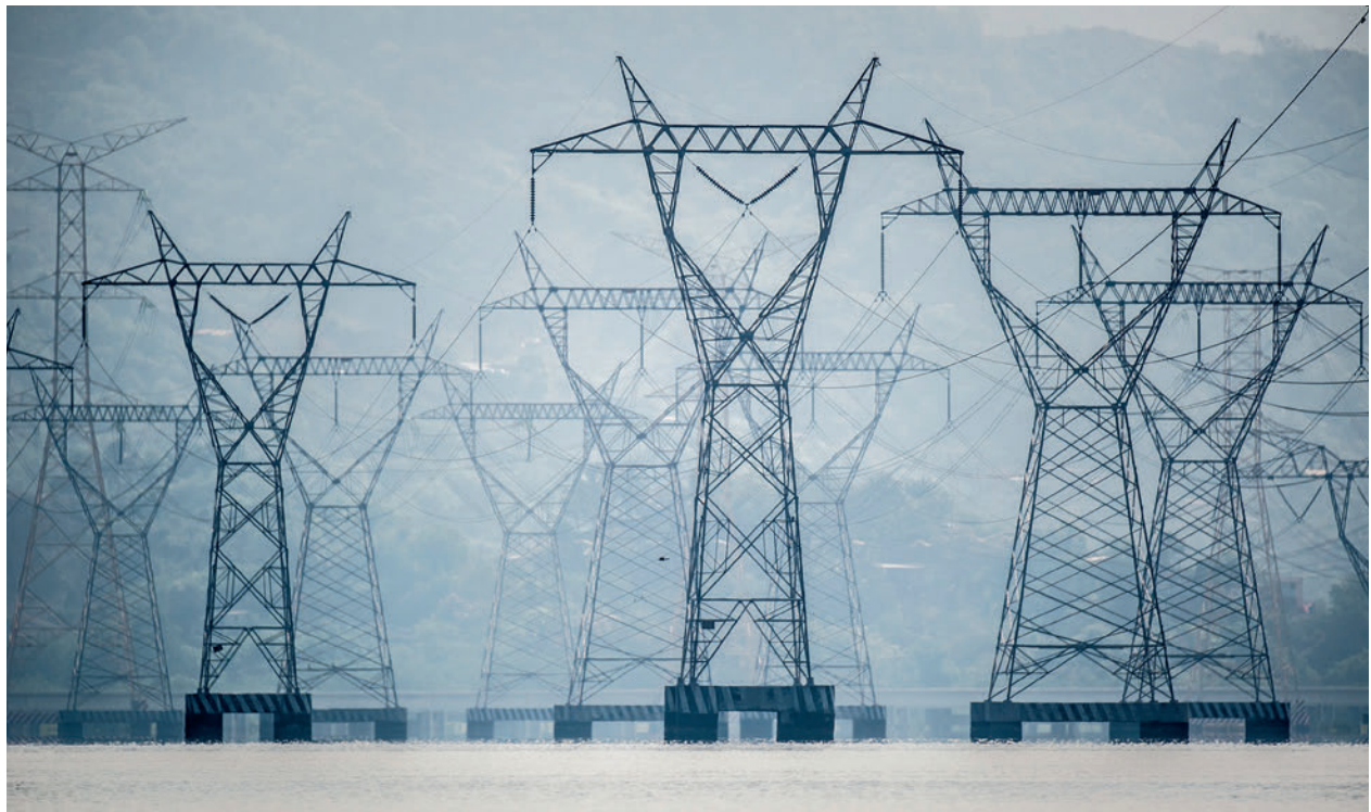
Fotografía 37. Torres de transmisión. Manzanillo, Colima. CFE.
