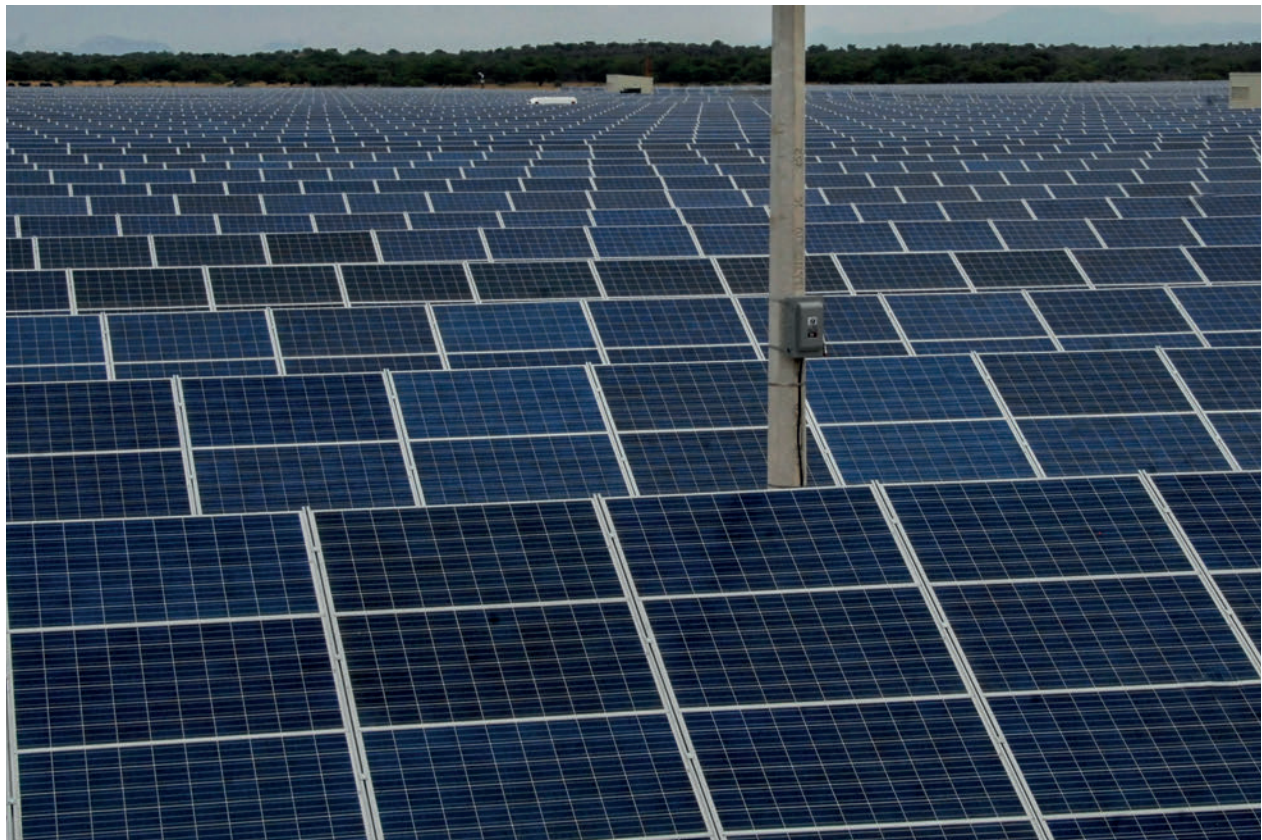
Fotografía 27. Campo fotovoltaico "Prieto". Mexicali, Baja California. CFE.
