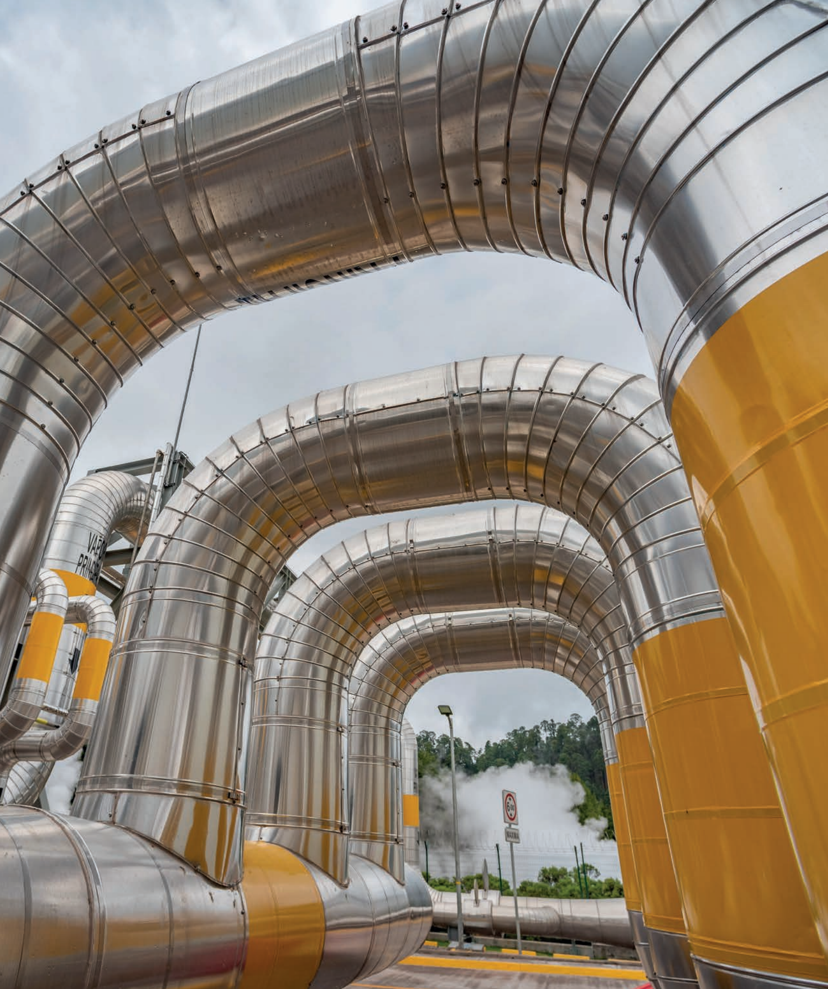
Fotografía 22. Central geotérmica, "Los Azufres". Michoacán. 2019. CFE.
