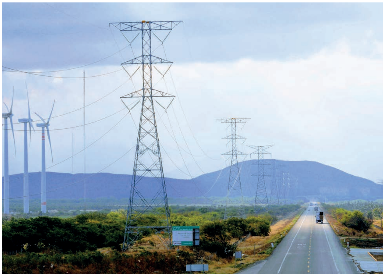
Fotografía 13. Torre de transmisión, Campo eólico. Oaxaca. CFE.
