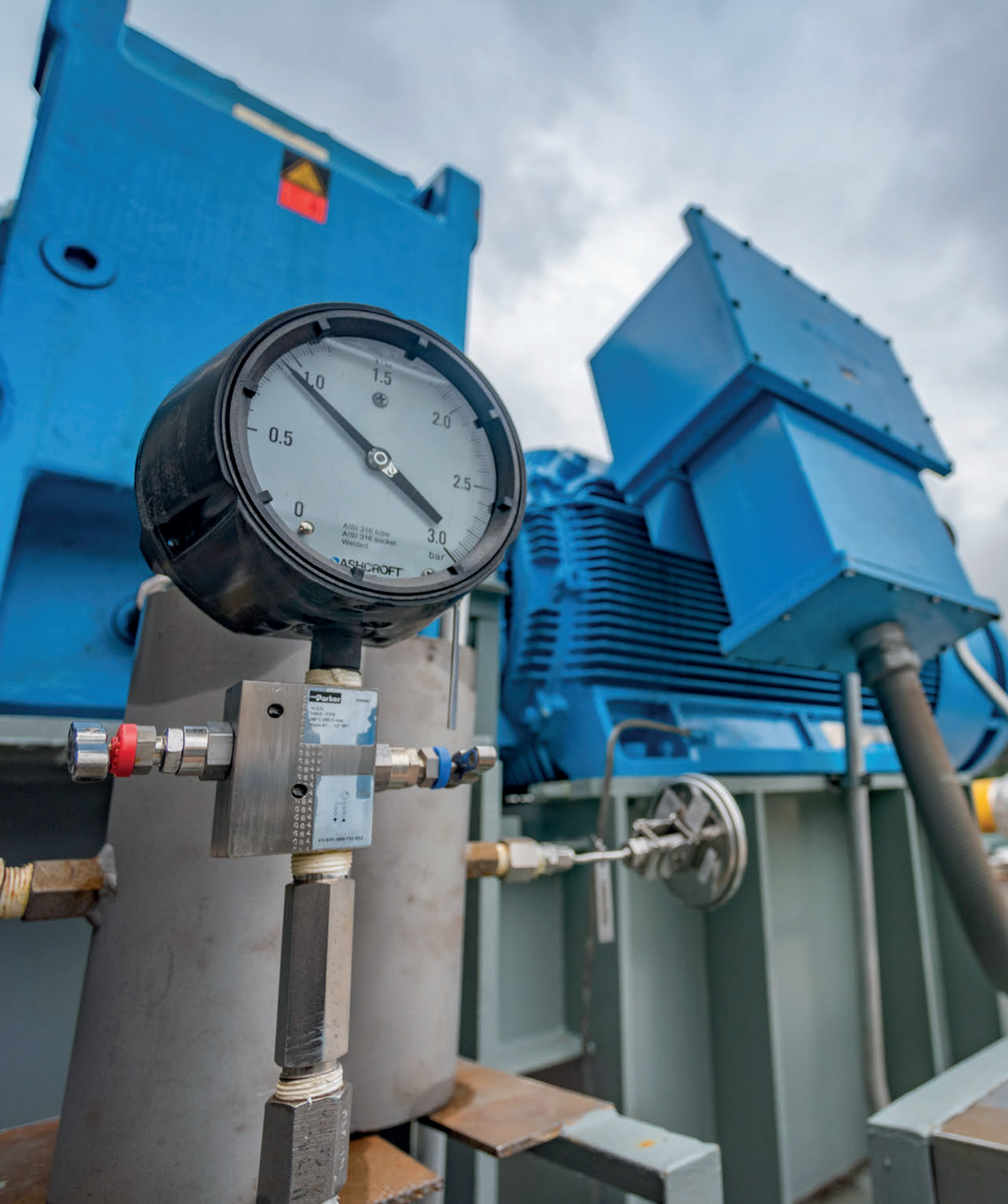
Fotografía 23. Central geotérmica "Los Azufres". Michoacán. CFE.
