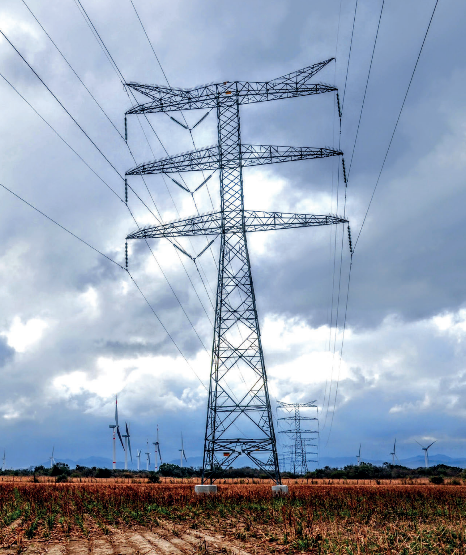
Fotografía 6. Torre de transmisión, Campo eólico. Sureste, Oaxaca. CFE.
