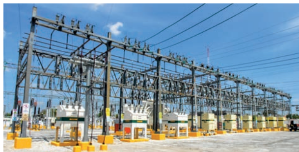
Fotografía 17. Subestación eléctrica, "Itzaes". Mérida, Yucatán. 2021. CFE.
