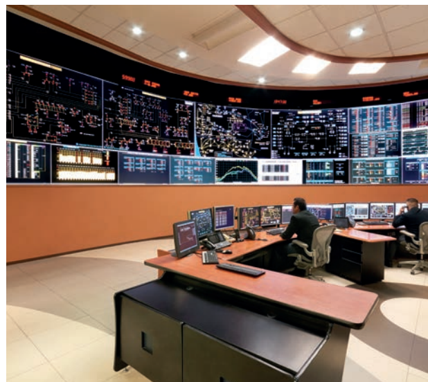
Fotografía 33. Centro de Control Baja California. CENACE.
