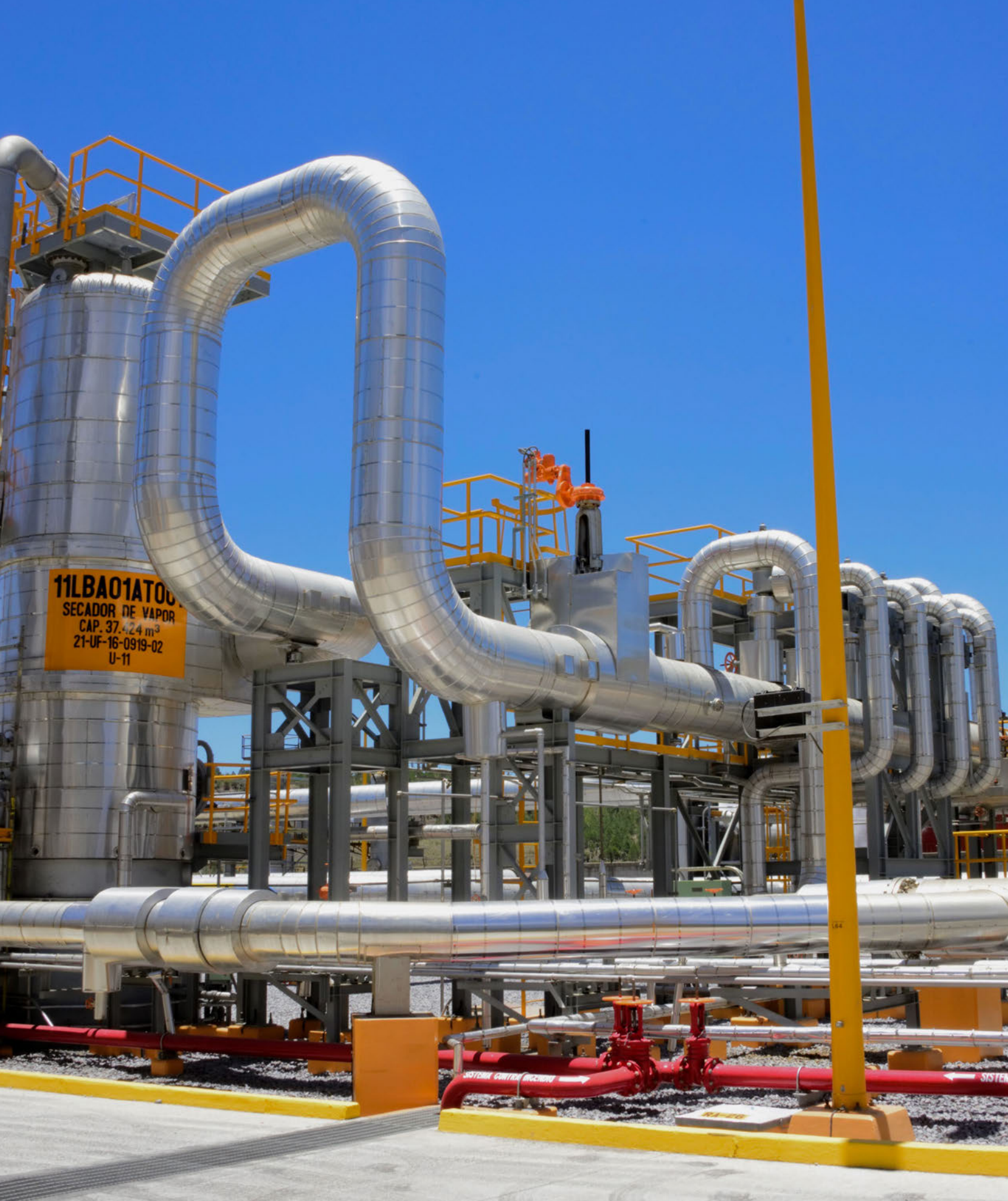
Fotografía 5. Central Geotérmica "Los Humeros". Puebla. CFE.
