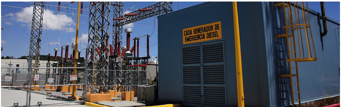
Fotografía 16. Subestación de transmisión. | Comisión Federal de Electricidad.
