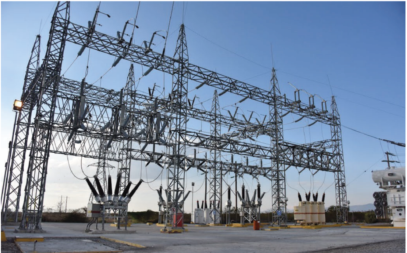
Fotografía 19. Subestación de distribución. | Comisión Federal de Electricidad.
