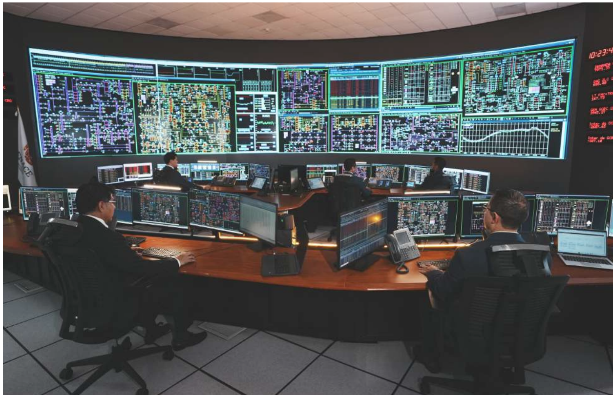
Sala de Control Operativo de la Gerencia de Control Regional Central. Ciudad de México.
