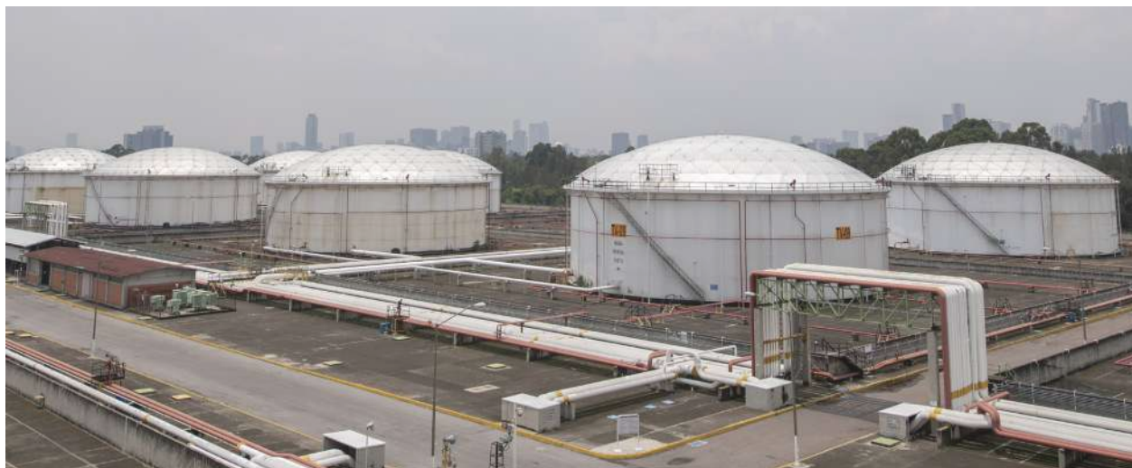
Terminal de almacenamiento y distribución. Ciudad de México.
