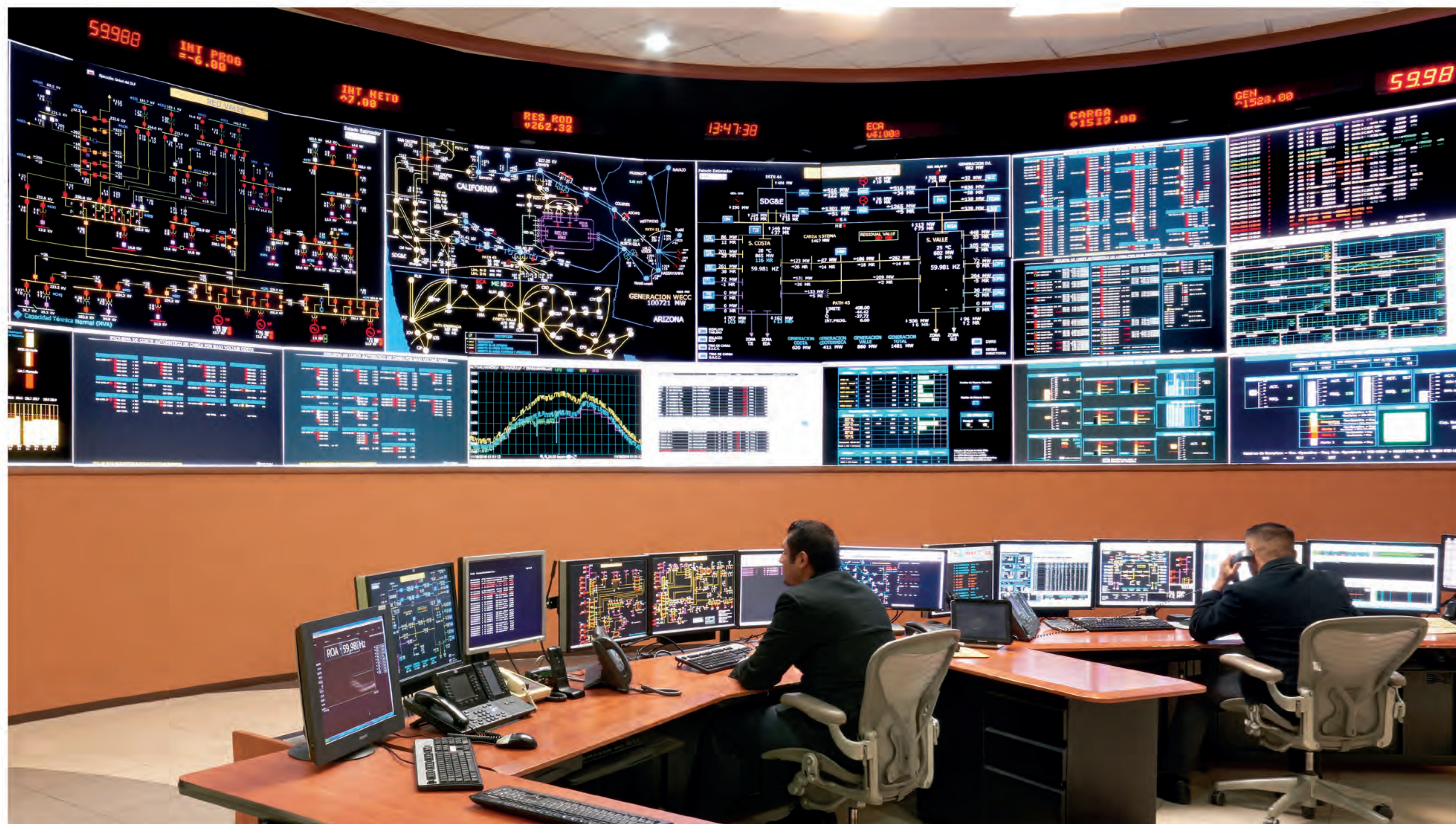
Fotografía 8. Sala de control, Baja California. Centro Nacional de Control de Energía.
