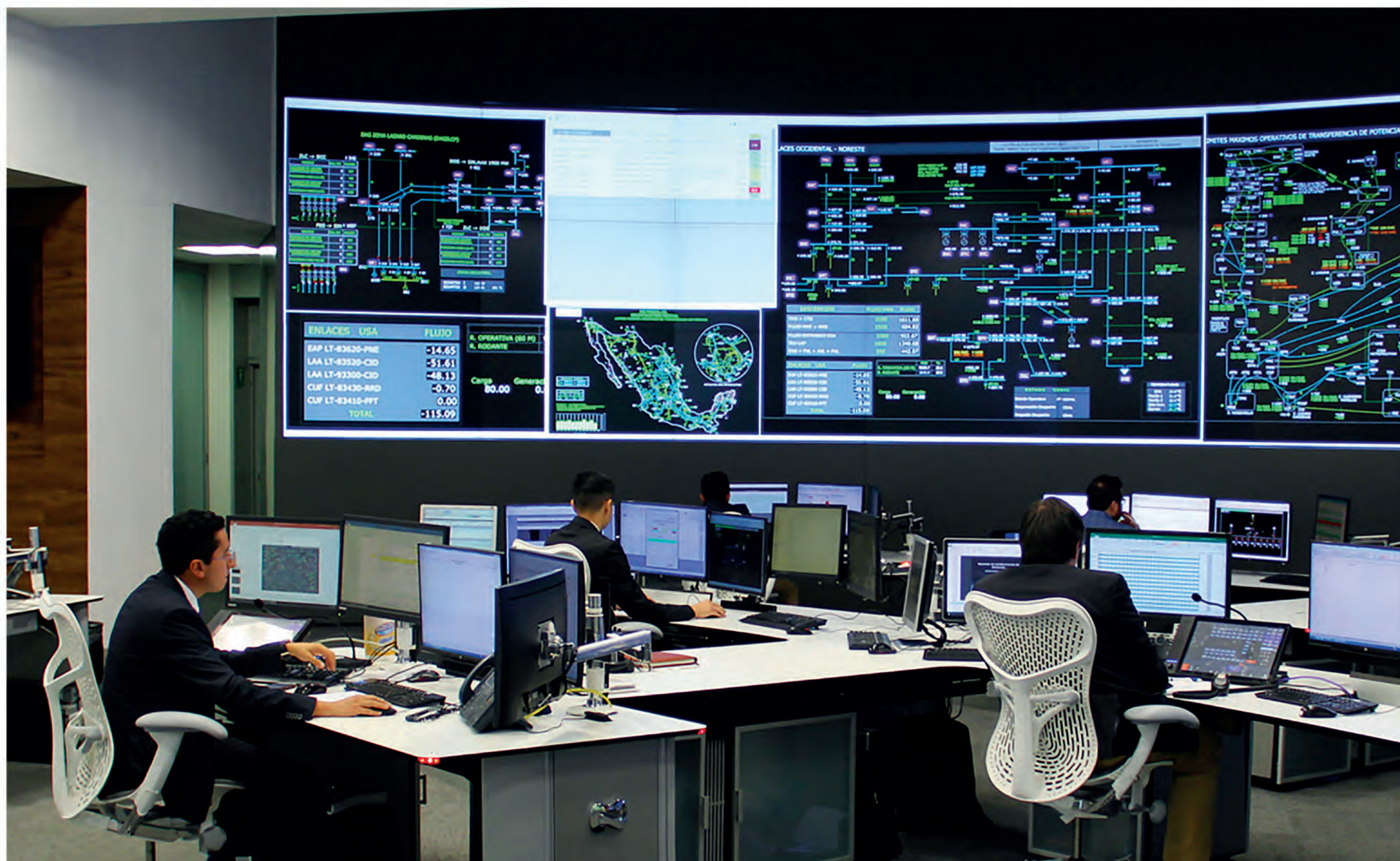
Fotografía 48. Sala de control. Centro Nacional de Control de Energía.
