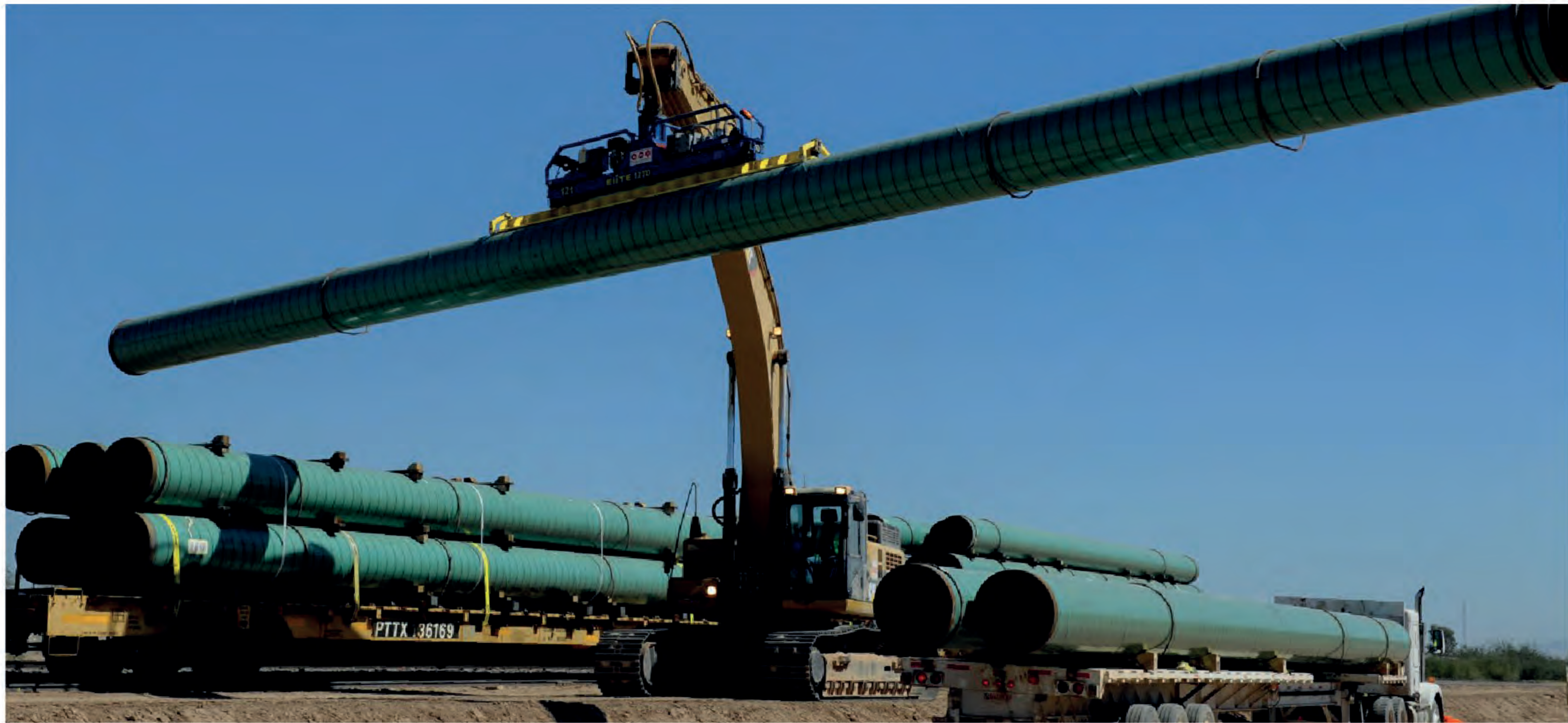
Fotografía 19. Gasoducto Norte-Noroeste en Caborca, Sonora. Secretaría de Energía.
