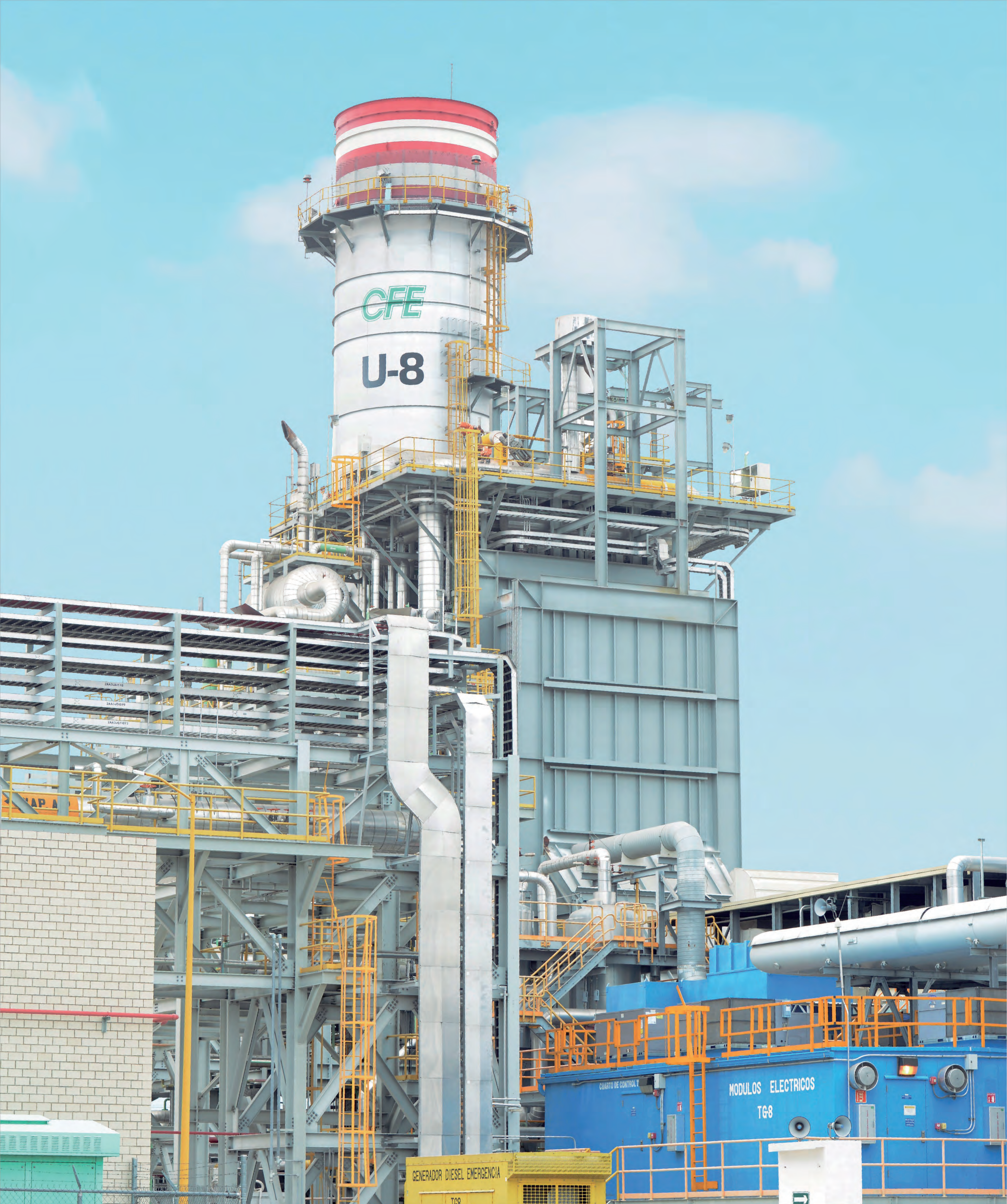
Fotografía 18. Central Ciclo Combinado El Sauz, en Querétaro. 20 de diciembre de 2020. Comisión Federal de Electricidad.
