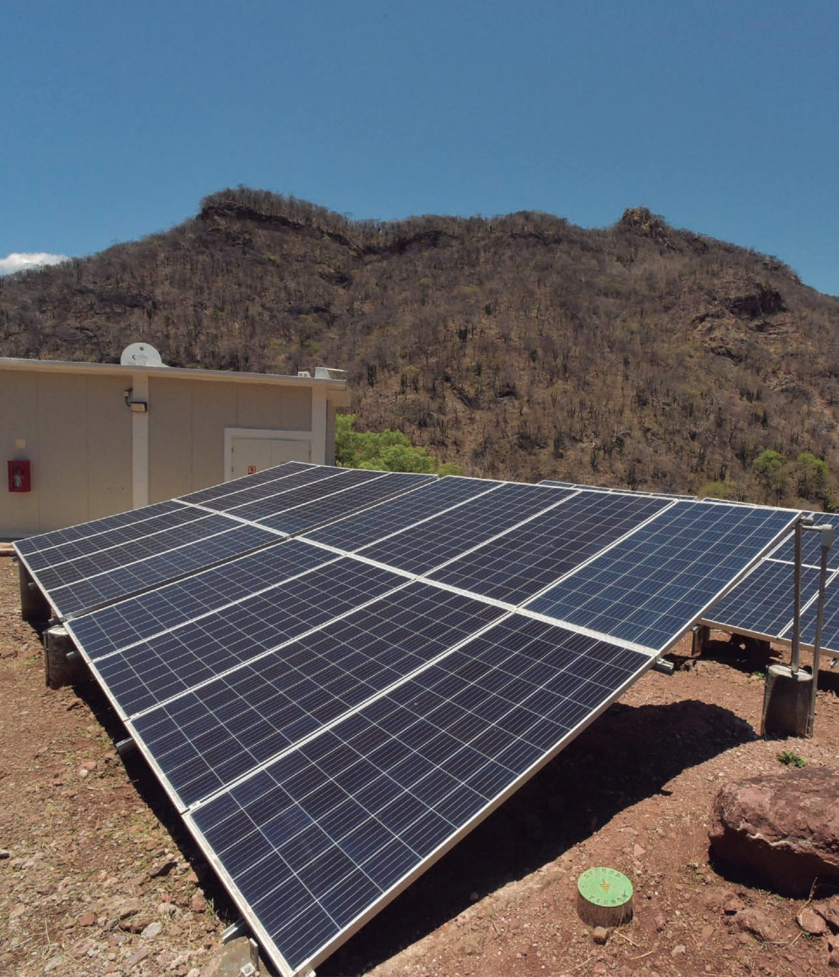
Campo solar, Álamos, Sonora. Comisión Federal de Electricidad.
