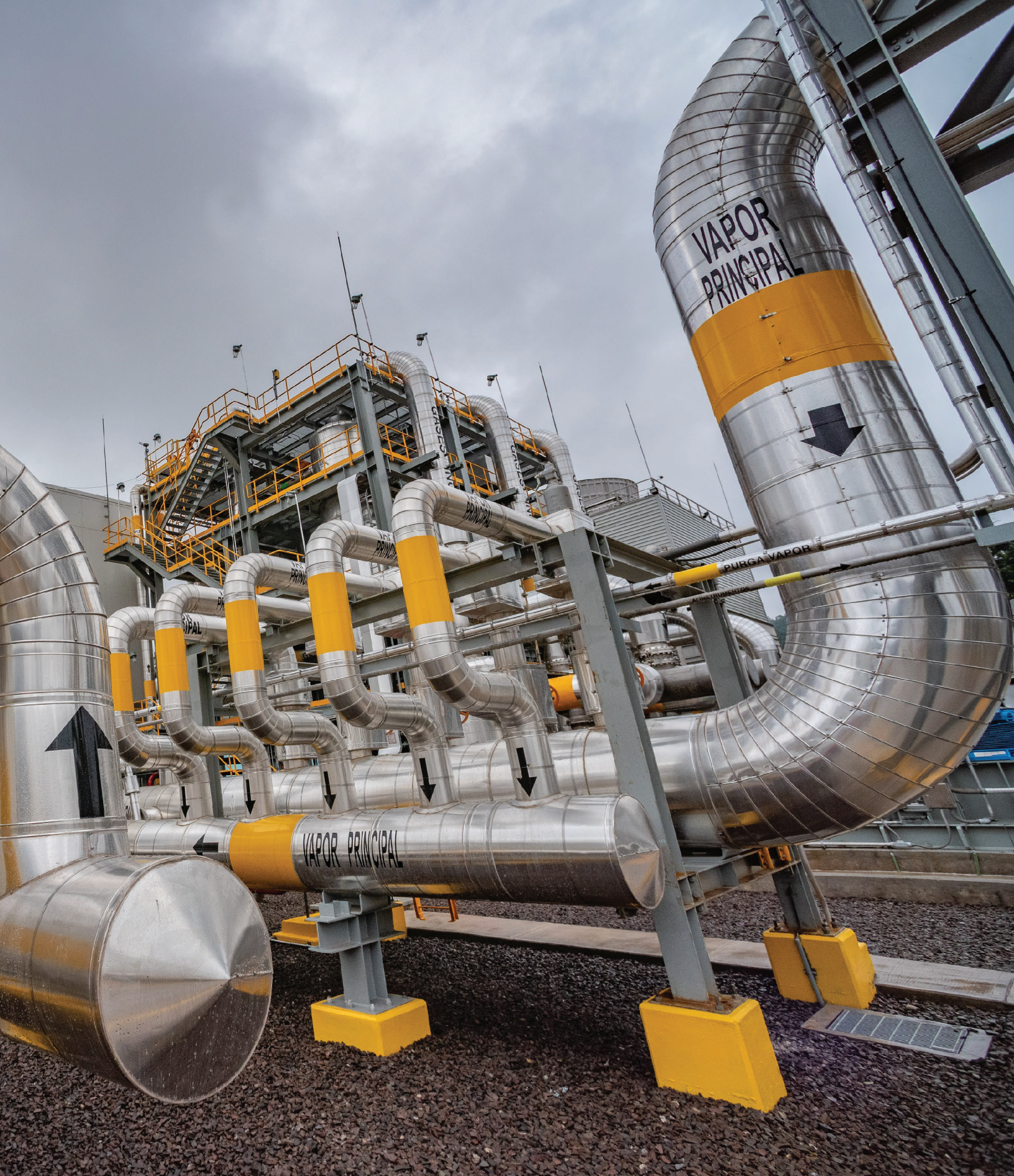
Central geotérmica, Ciudad Hidalgo, Michoacán. Comisión Federal de Electricidad.
