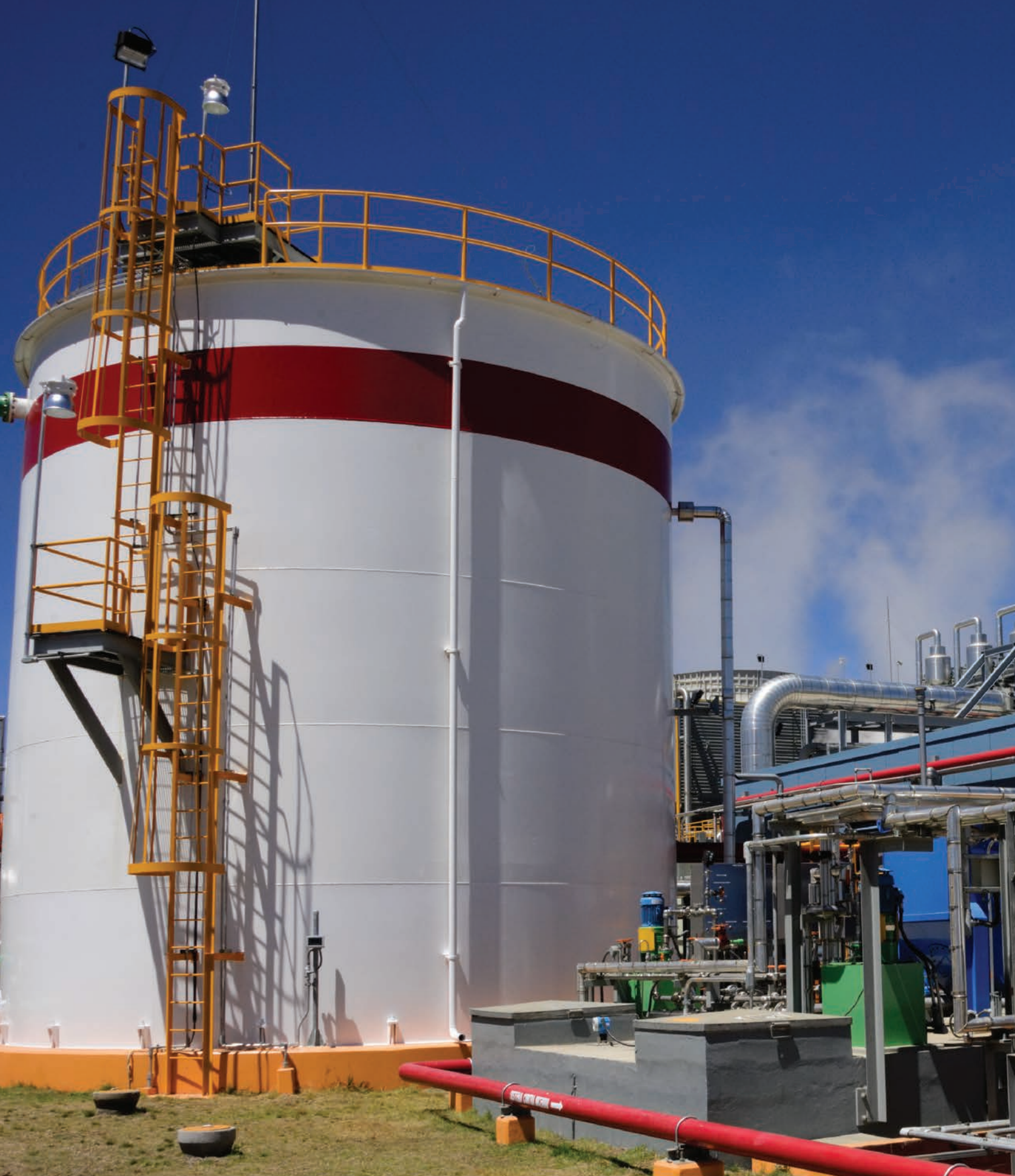
Central geotérmica, Chignautla, Puebla. Comisión Federal de Electricidad.
