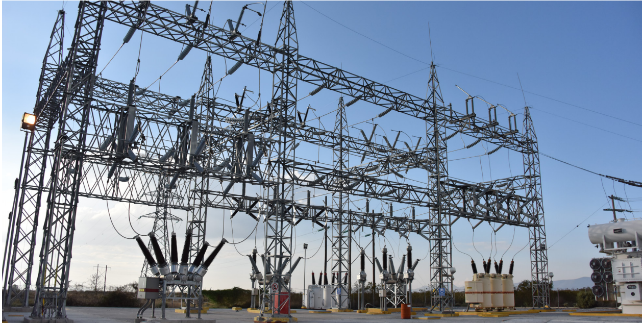
Subestación eléctrica. Saltillo, Coahuila. Comisión Federal de Electricidad.
